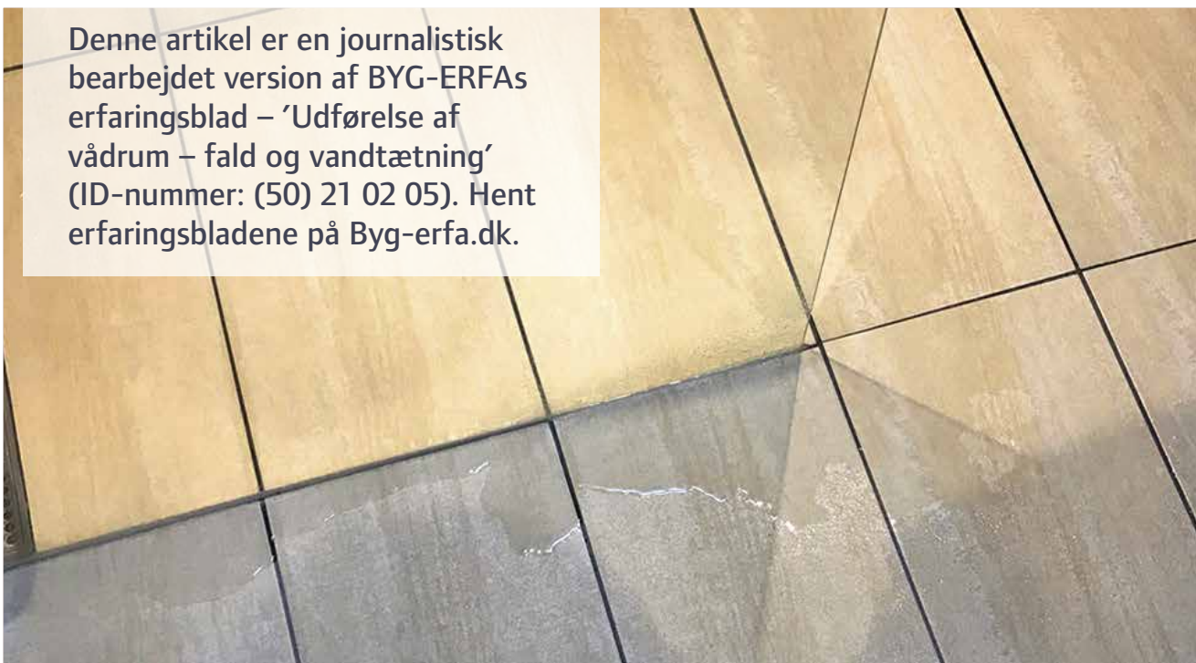
Bruseniche, hvor vandet løber uden om skærmvæg på grund af bagfald og manglende forsækning.
